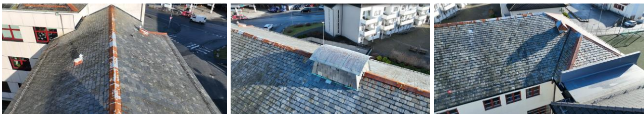
Utklipp 2 - 9 stk utklipp frå dronevideoar frå Ose (2023) som viser behovet for å skifte ut taket.
